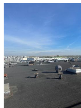
Équipements sur le toit d'un hypermarché
