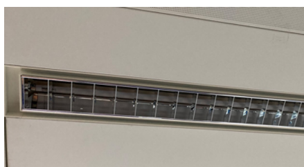
Avant : encastré fluorescent existant (marque tierce).
